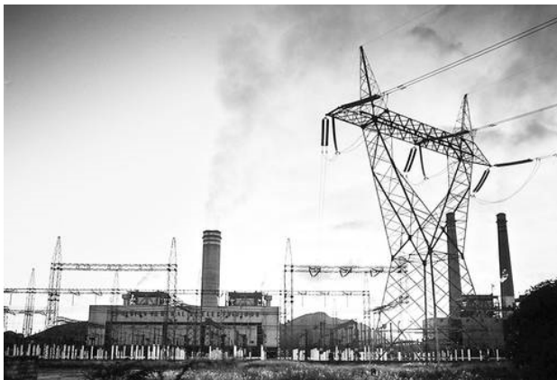
Líneas de transmisión eléctrica de la CFE
