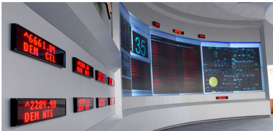
Centro Nacional de Control de Energía
